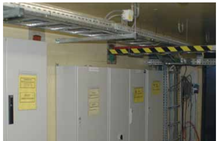
Rittal toepassingen in het sluizencomplex
